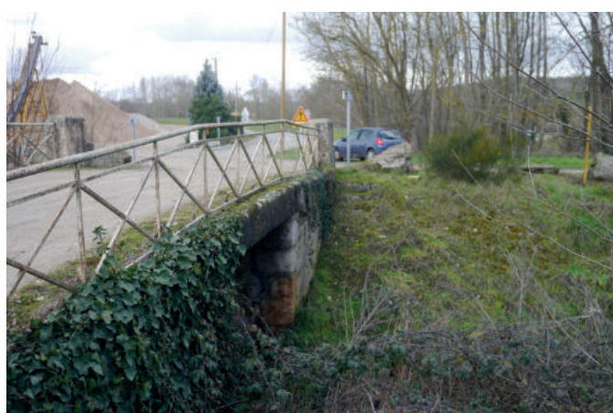
Pont de franchissement du canal de Berry au niveau d'une section remblayée, et de la gravière voisine (La Perche). L'ouvrage n'est plus entretenu, les perrés et escaliers s'effacent.
