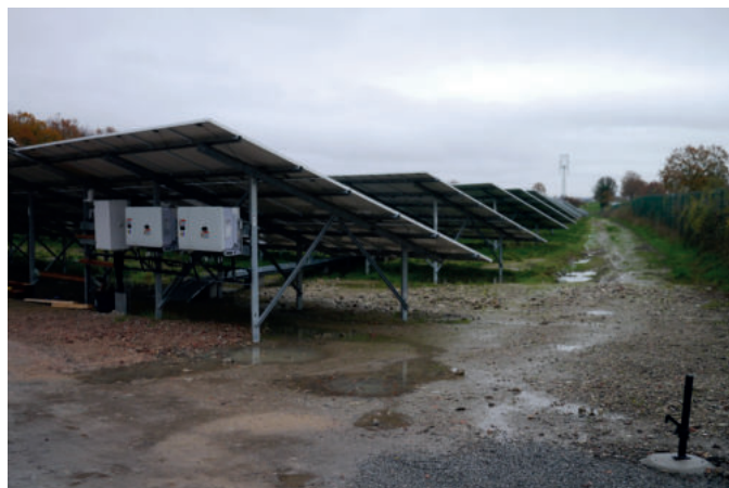
Panneaux photovoltaïques sur une ancienne parcelle cultivée à l'entrée de Commentry
